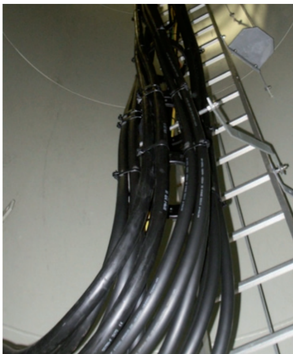
Gute Installation mit gummierten metallenen Befestigungen
