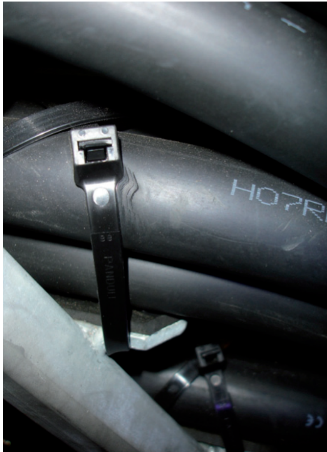
Kabelbinder mit kleinen Auflageflächen führen zu hohen mechanischen Belastungen, die im Zusammenwirken mit Ozon und Feuchtigkeit eine Rissbildung des Mantels bewirken können
