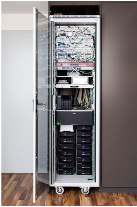
So viel Technik verlangt zentrale Koordination. Ohne Schaltschrank kommt das Smart Home nicht aus.
