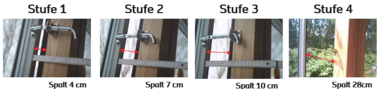
Abb 21: PES Rostock, Fensteröffnungsspalt mit verschiedenen Öffnungsweiten.
