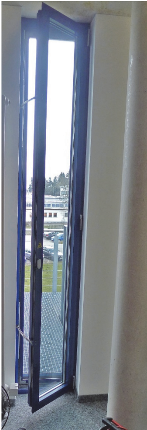
Abb 15: Deckenhoher Drehflügel zur natürlichen Lüftung.
